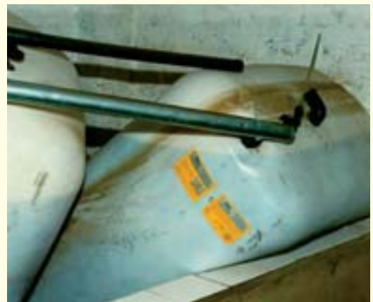
Ungeeigneter Heizöltank nach einem Hochwasserereignis.
