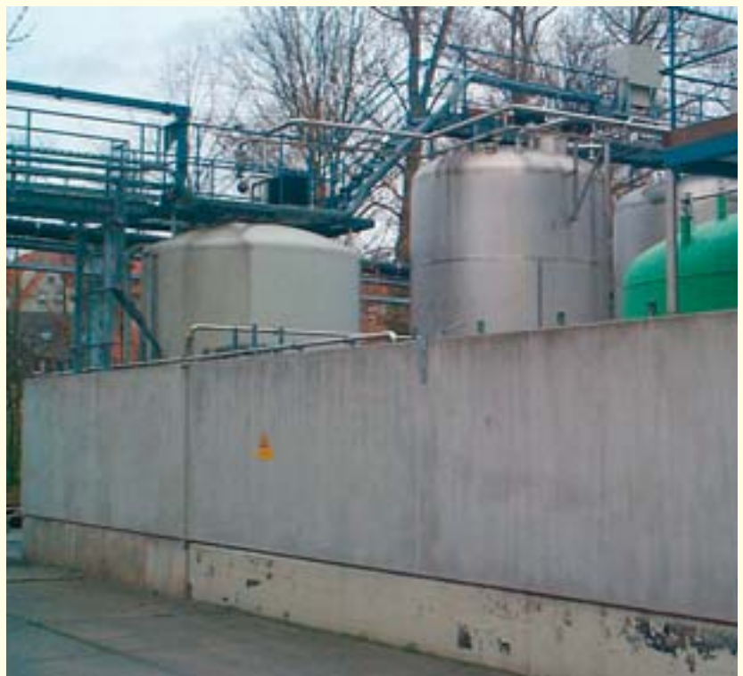
Im Freien aufgestellte Lagerbehälter für wassergefährdende Stoffe sind mit einer ausreichend hohen Schutzmauer umgeben.
